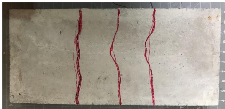
Figura 4-20 Patrón de fisuras de la losa maciza, vista en planta Fuente: Autores
