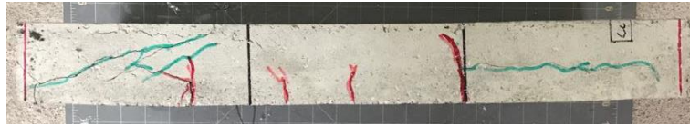
Figura 4-23 Patrón de fisuras de la losa unidireccional, vista lateral Fuente: Autores
