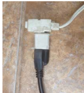
Figura 3-29 Conexión eléctrica del cable de compresor
