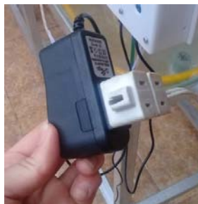
Figura 3-30 Conexión eléctrica de los cables del sistema eléctrico de limpieza
