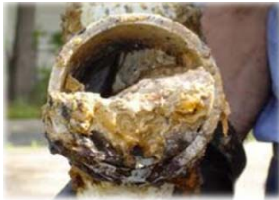
Figura 1-1 Obstrucción de una tubería por efecto de grasas y aceites.
