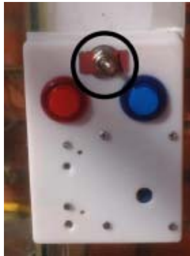
Figura 3-43 Interruptor encendido del sistema eléctrico
