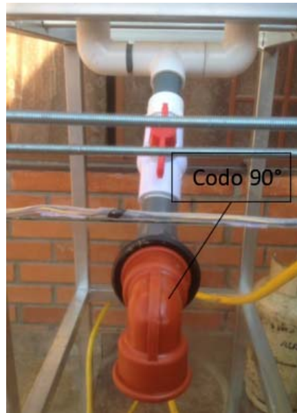
Figura 2-27 Vista frontal del sistema de circulación del afluente.
