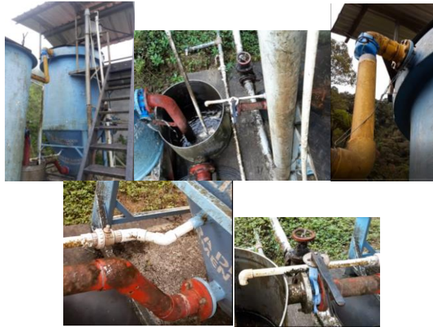
Figura 3.12. Conexiones de llaves y tuberías anexas al sedimentador, STAP Fuente: Autores
