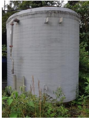
Figura 3.21. Tanque de homogenización, STAR Fuente: Autores
