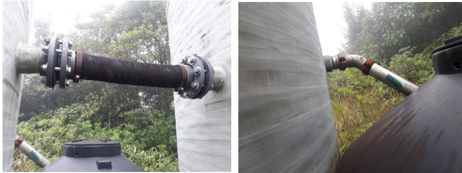
Figura 3.20. Conexiones de llaves y tuberías anexas al tanque de homogenización, STAR Fuente: Autores
