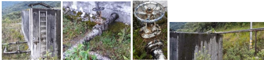
Figura 3.16. Conexiones de tuberías anexas al tanque de almacenamiento, STAP
