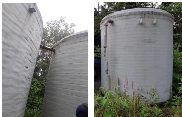
Figura 3.25. Tanques de aireación, STAR Fuente: Autores
