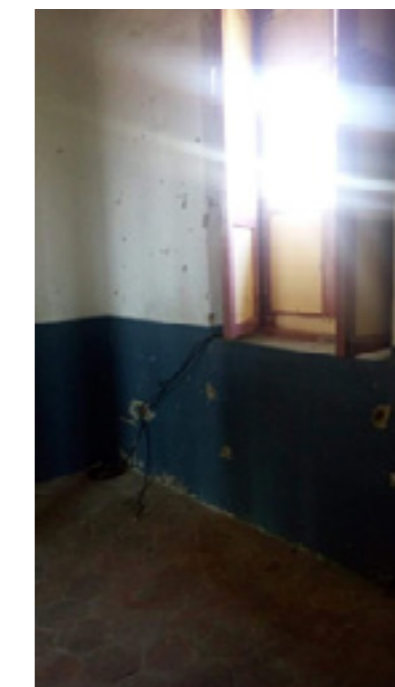
Ilustración 27: Perspectiva del deterioro de paredes
