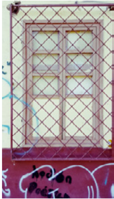
Ilustración 29: Perspectiva del deterioro de ventanas exteriores
