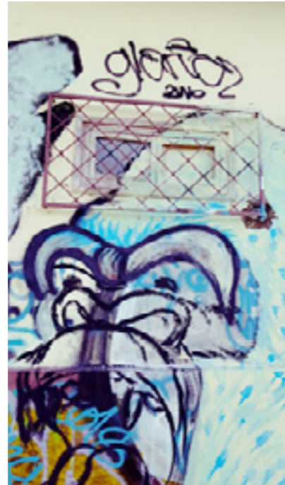
Ilustración 30: Perspectiva de las paredes con vandalismo
