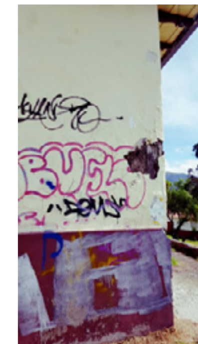
Ilustración 28: Perspectiva del deterioro de paredes exteriores
