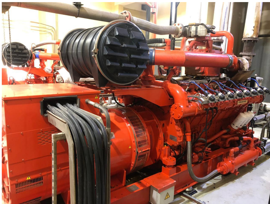
Figura 1.2 Motor Generador del Relleno Sanitario de Pichacay
