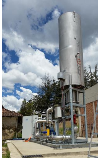
Figura 1.9 Bioprocesador y antorcha del Relleno Sanitario de Pichacay
