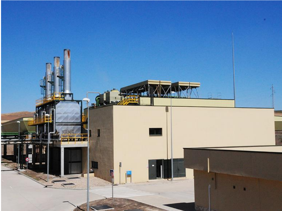
Figura 2.4 Unidad de Tratamiento de Lodos en Loeches
