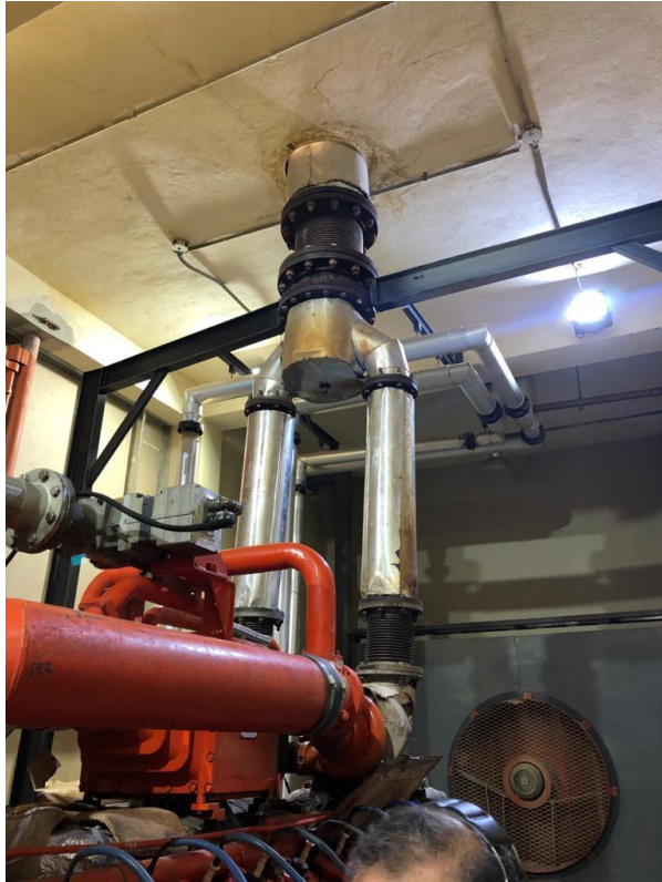
Figura 3.17 “Pantalón” del motor generador a biogás
