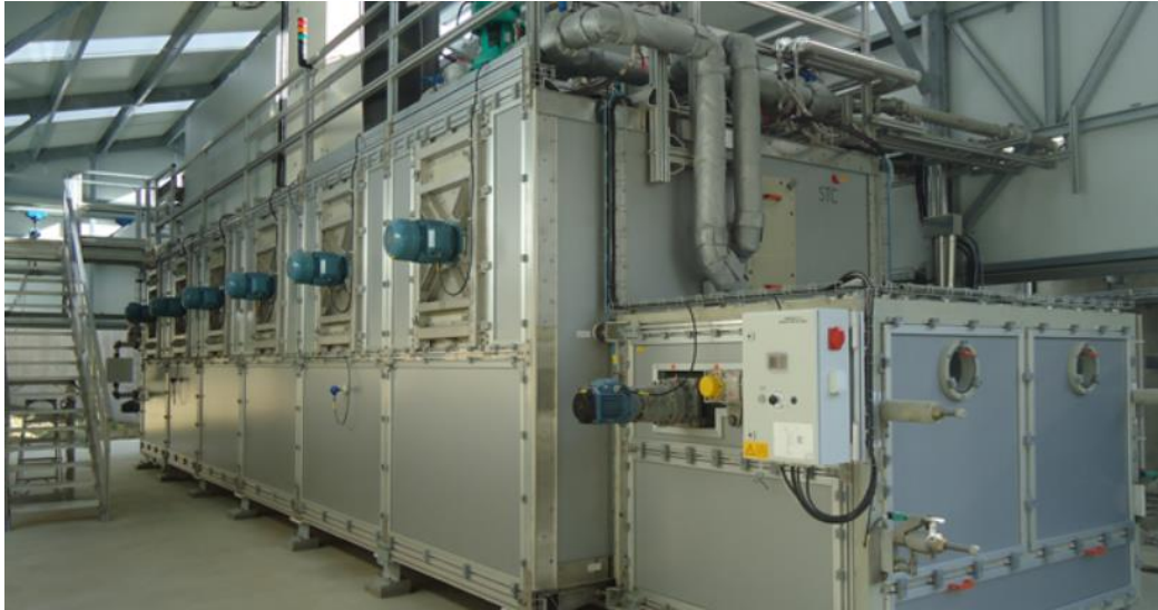
Figura 3.13 Equipo STC implantado en una Estación Depuradora de Aguas Residuales
