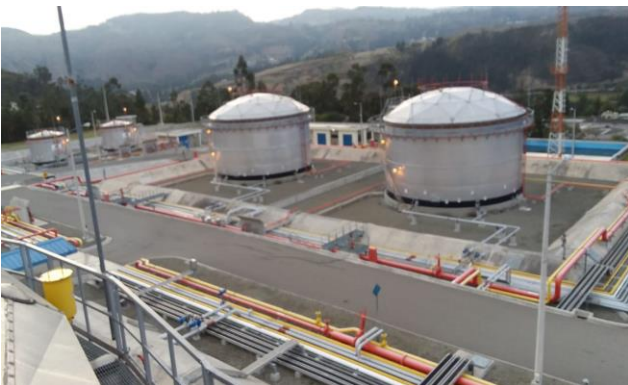
Fig. 3. Sistema de Almacenamiento de combustibles
