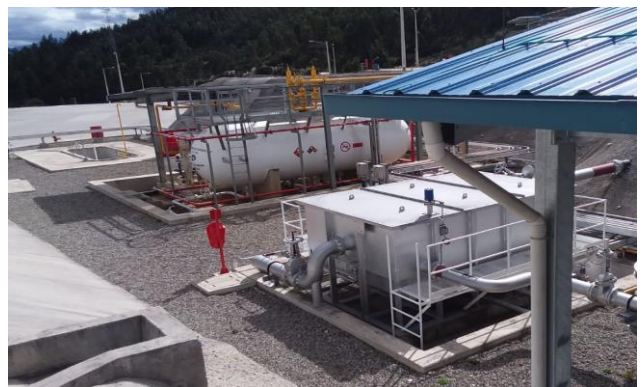
Fig. 7. Sistema tanques horizontales
