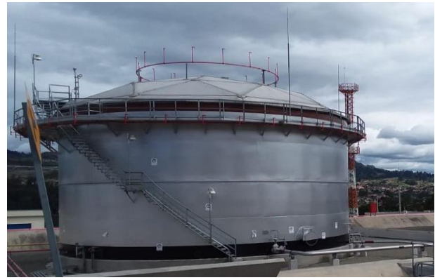
Fig. 8. Tanque de almacenamiento
