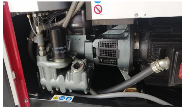
Fig. 9. Compresor de aire
