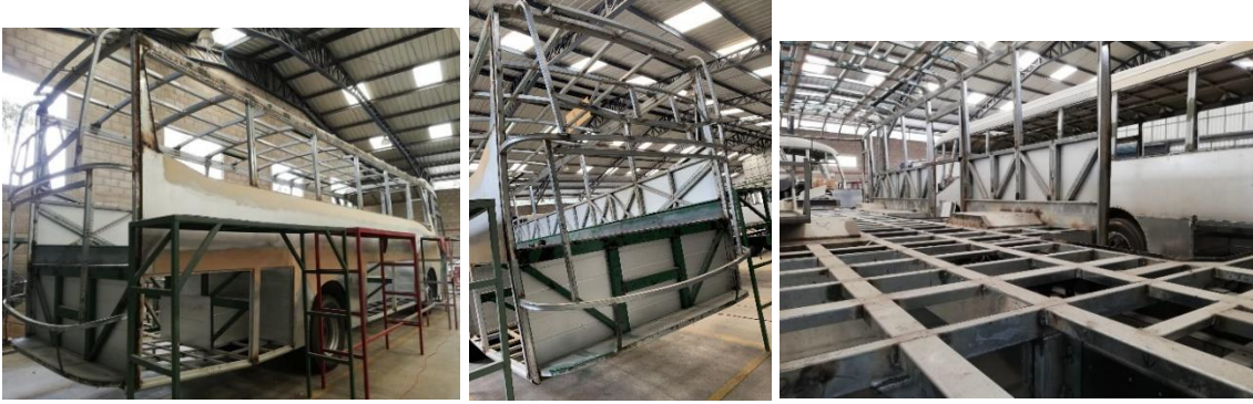
Figura 3.5. Configuración del armado de una estructura de autobús interprovincial Referencia: Empresas carroceras ubicadas en la ciudad de Cuenca.
