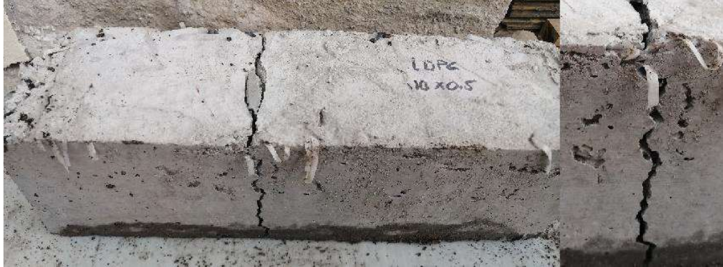
Fotografía 5-5 Fisura Viga LDPE 10*0.5. Fuente: Autores
