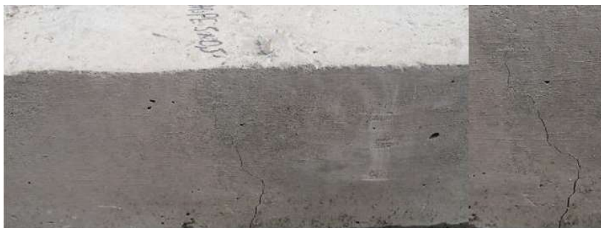
Fotografía 5-2 Fisura Viga HDPE 10*0.5. Fuente: Autores
