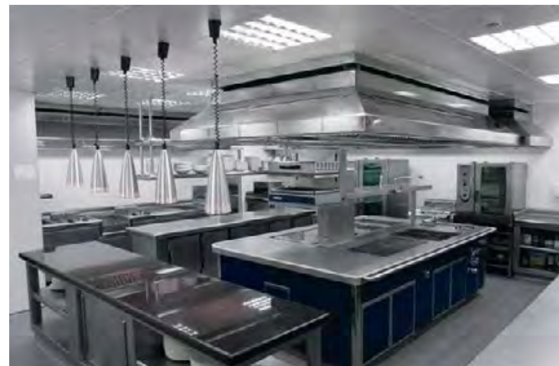
Imagen 9: Cocina industrial Autor: Hosterverga
