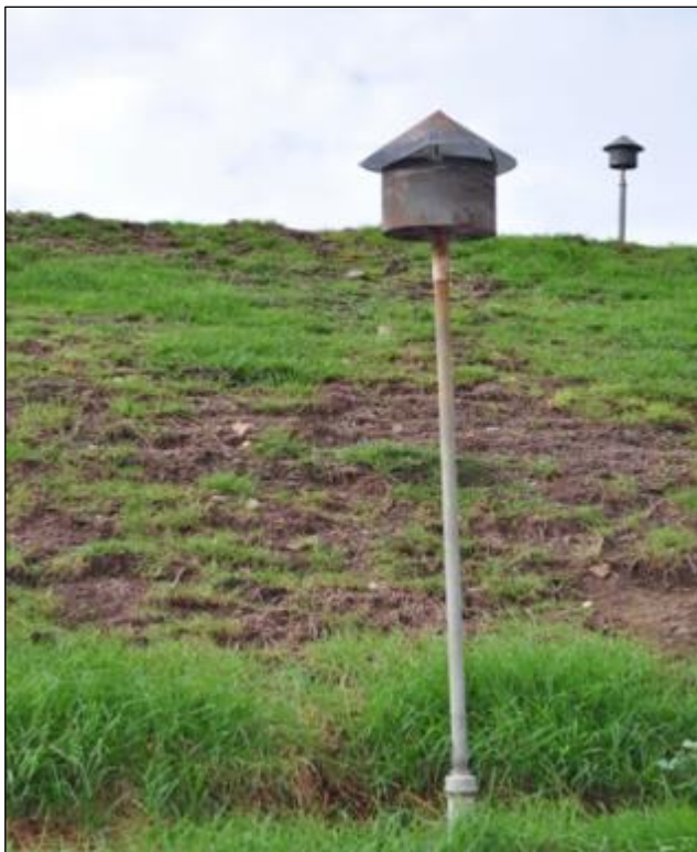
Figura 2.19. Caseta de incineración del biogás.
