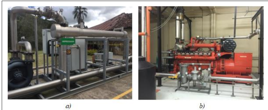
Figura 2.21. (a) Bioprocesador; (b) equipo generador de energía eléctrica [Fotografía].
