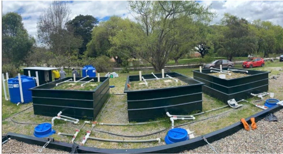
Figura 2 Sistema construido de humedales tipo francés Fuente: Autor propio
