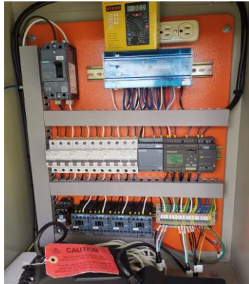
Figura 7 Controlador Lógico Programable Fuente: Autor propio
