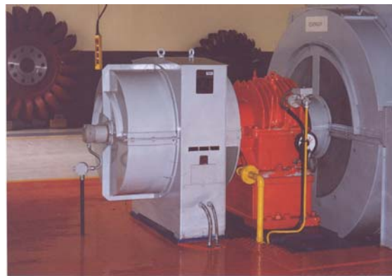
Central Saucay Vista parcial de turbina
