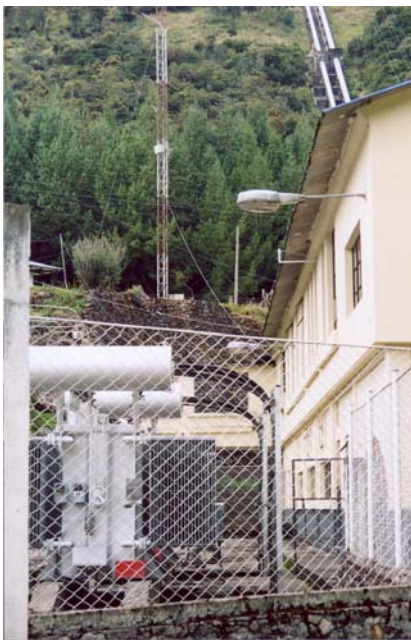
Central Saucay Vista de tubería de presión y Transformador de elevación
