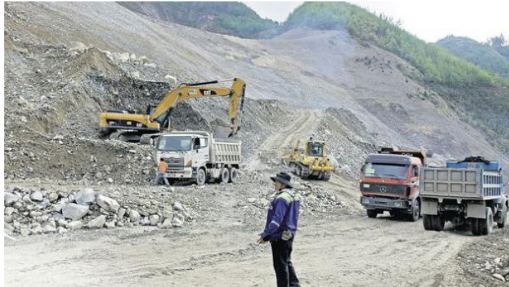
Figura 1.2 Los trabajos se siguen realizando años después del desastre de la Josefina.
