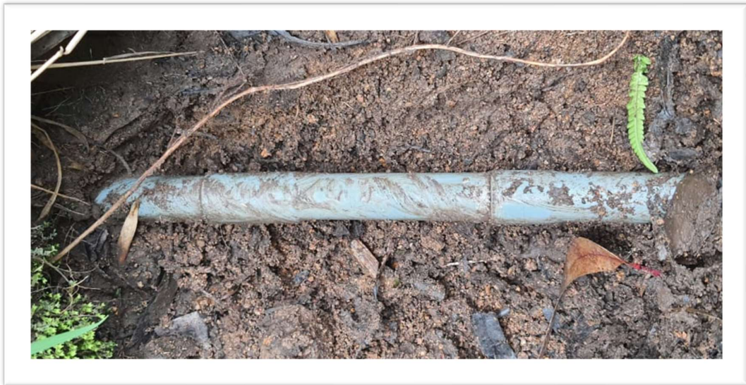
Imagen 5.7: Cateo #1 de Tubería en red de distribución.
