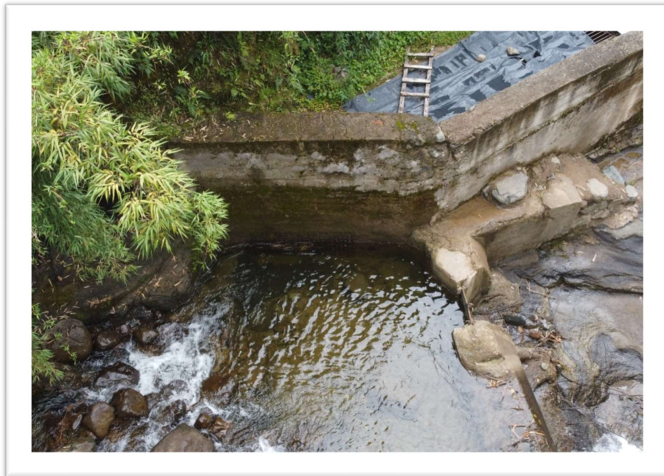
Imagen 5.1: Captación en el Río Saymirin con rejilla lateral.
