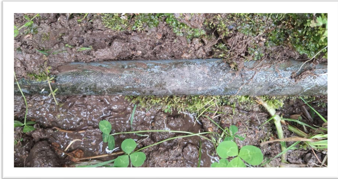
Imagen 5.8: Cateo #2 de Tubería en red de distribución.
