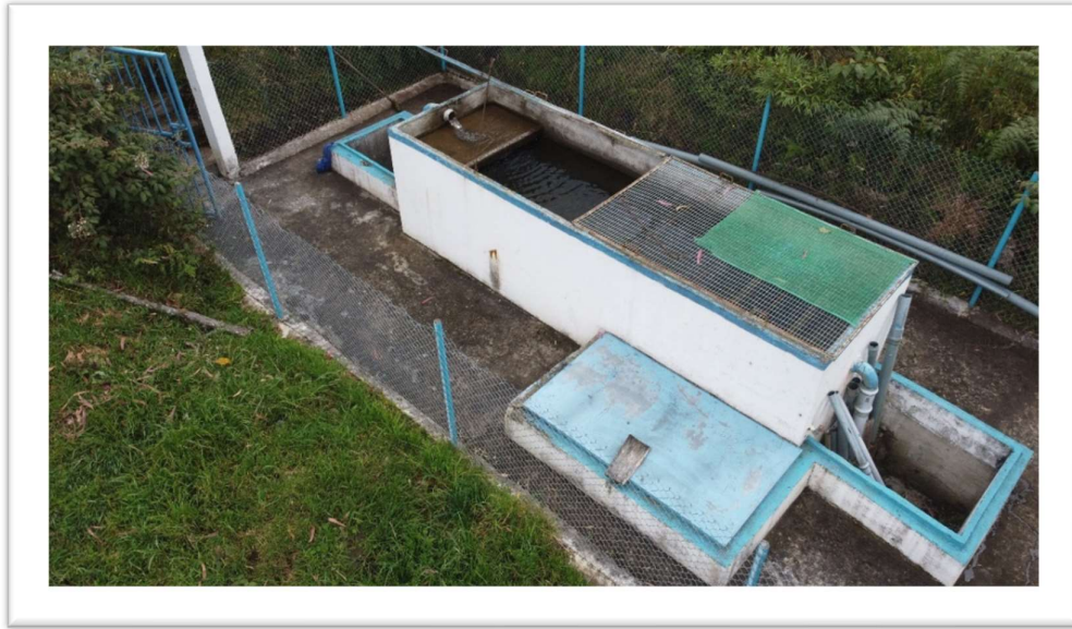
Imagen 5.2: Desarenador Santa Teresita.
