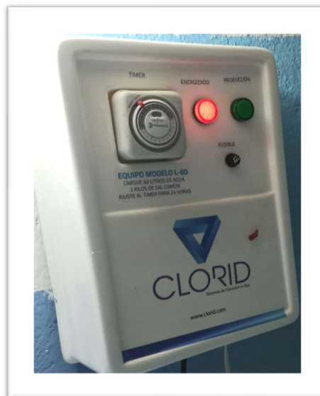
Imagen 5.5: Sistema de cloración de la PTA.
