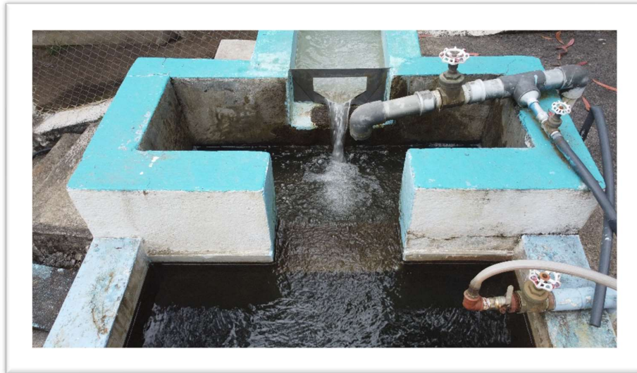
Imagen 5.3: Cajón de ingreso a planta de tratamiento (Vertedero Triangular).
