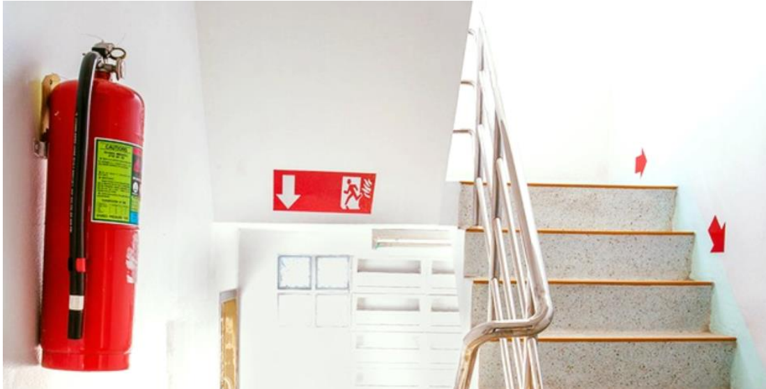
Figura 3.1: Extintores ubicados en la entrada del ascensor en cada planta Fuente: (Elaboración Propia)
