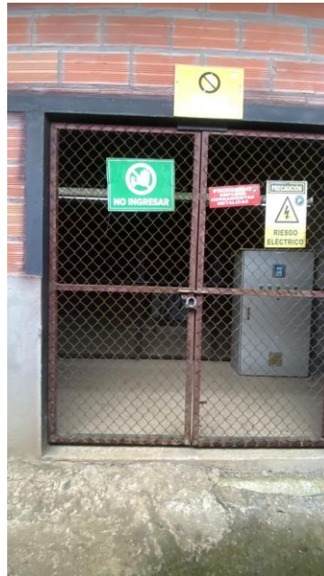
Figura 13 Cuarto de electricidad de la Sociedad Minera Reina del Cisne
