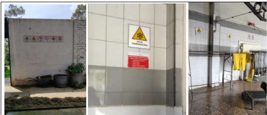
Cuarto de máquinas
