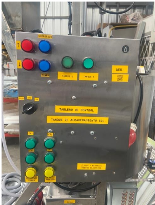
Figura.39. Tablero de control.
