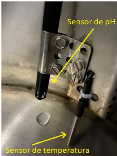
Figura.51. Colocación de sensor de pH y sensor de temperatura en el tanque de almacenamiento
