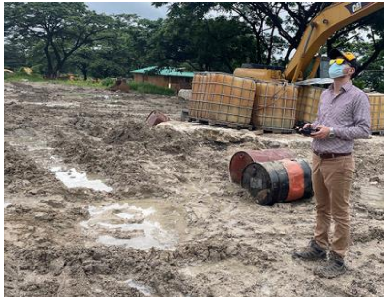
Ilustración 18. Superficie irregular en el área de combustible Fuente: Propia (2022).
