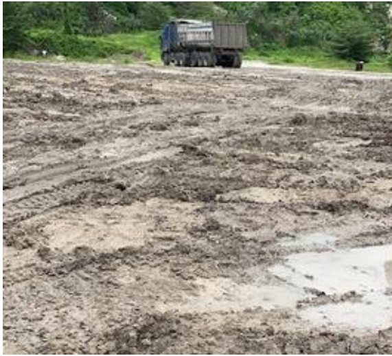
Ilustración 12. Depósito de barro. Fuente: Propia (2022)
