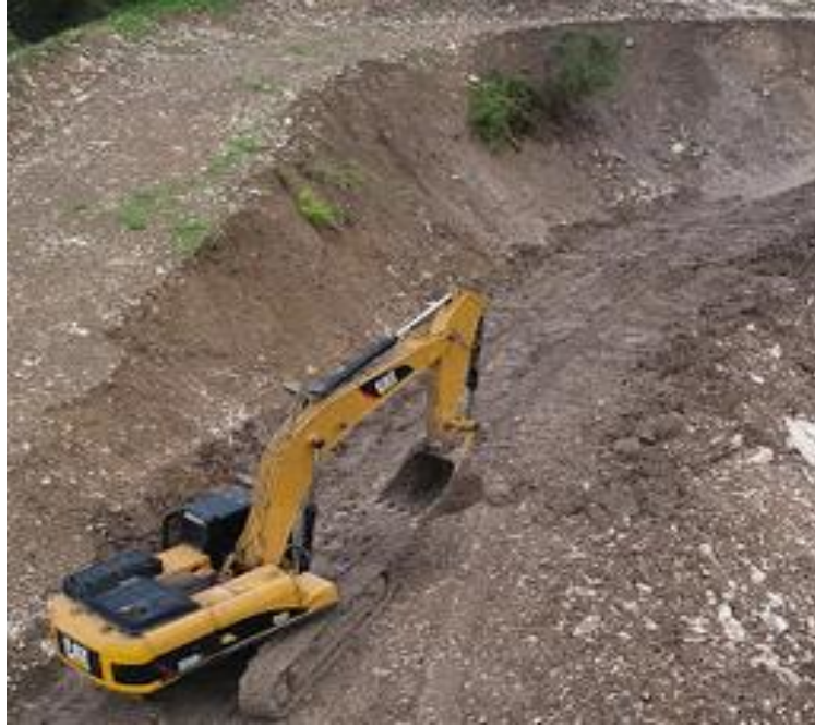
Ilustración 17. Plataformas sin barreras de protección. Fuente: Propia (2022).
