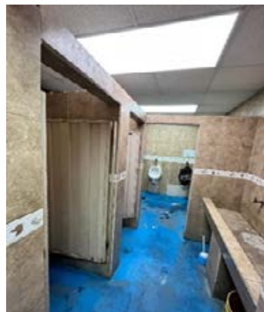
Imagen 14: Baños de la Piscina Olímpica Fuente: Fotografía Propia
