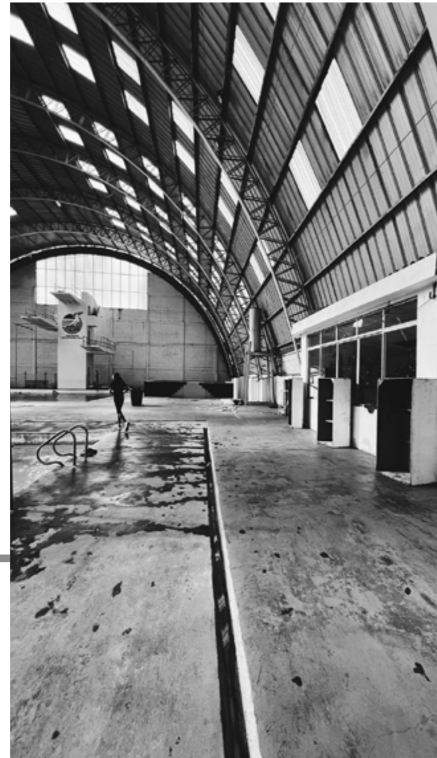
Imagen 42: Estado actual de la Piscina Olímpica. Fuente: Elaboración Propia.
