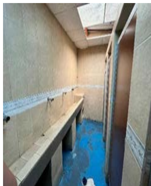
Imagen 13: Baños de la Piscina Olímpica Fuente: Fotografía Propia
