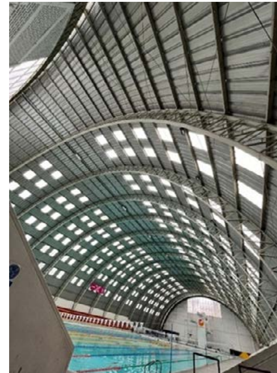
Imagen 11: Estado Actual de la Piscina Olímpica, tragaluces y ventanales posterior e inferior. Autor: Fotografía propia
