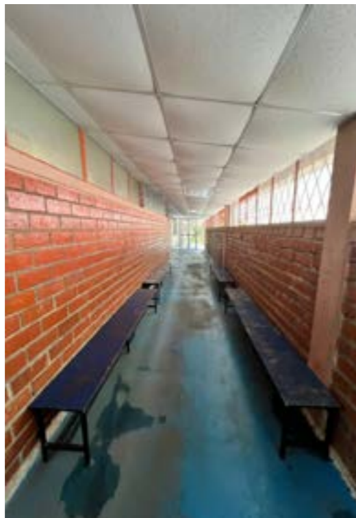
Imagen 46: Estado actual del pasillo. Fuente: Elaboración Propia.
