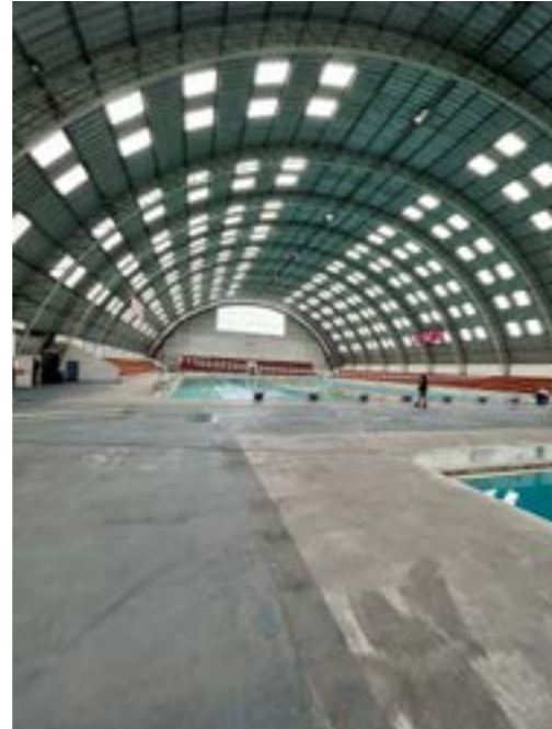
Imagen 44: Estado actual de las piscinas. Fuente: Elaboración Propia.
