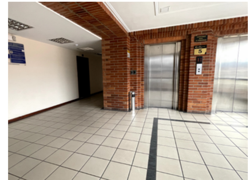
Figura 23: Ascensor del Piso #2
