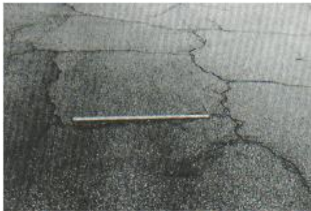
Ilustración 2-3: Grietas en bloque de media severidad
