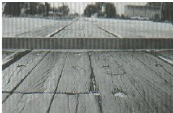
Ilustración 2-14: Cruce de vía Férrea de baja severidad, Fuente: Vásquez, 2002.
