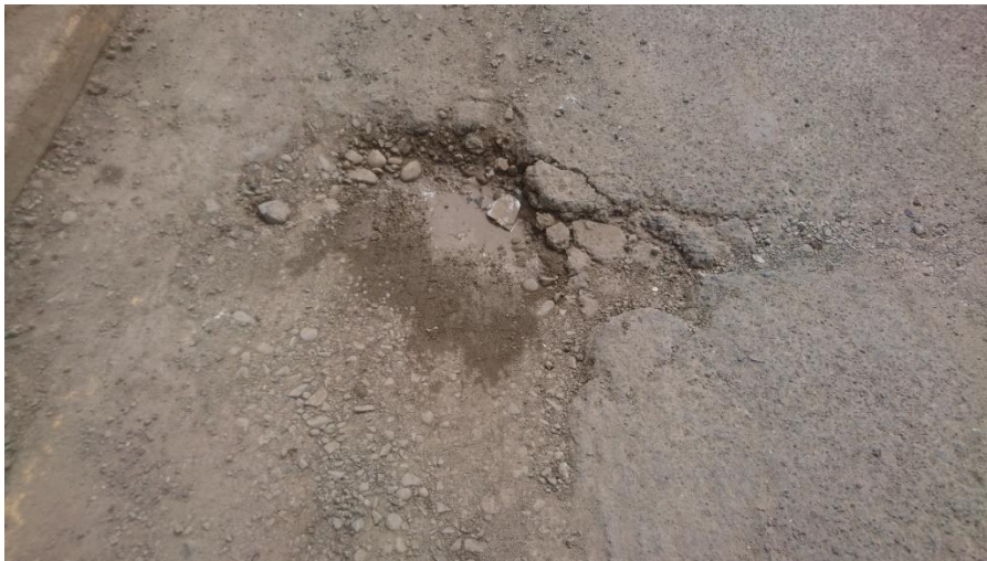
Ilustración 2-13: Hueco de alta severidad, Fuente: Autor.
