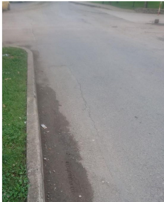
Ilustración 2-10: Grietas longitudinales o transversales de baja severidad, Fuente: Autor.
