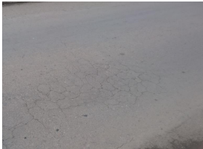
Ilustración 2-1: Piel de Cocodrilo de severidad media, Fuente: Autor
