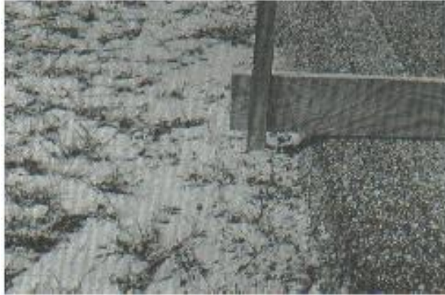
Ilustración 2-9: Desnivel carril/berma de baja severidad Fuente: Vásquez, 2002.
