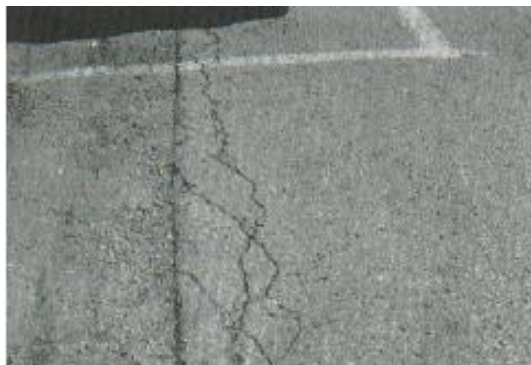
Ilustración 2-7: Grieta de borde de media severidad Fuente: Vásquez, 2002.
