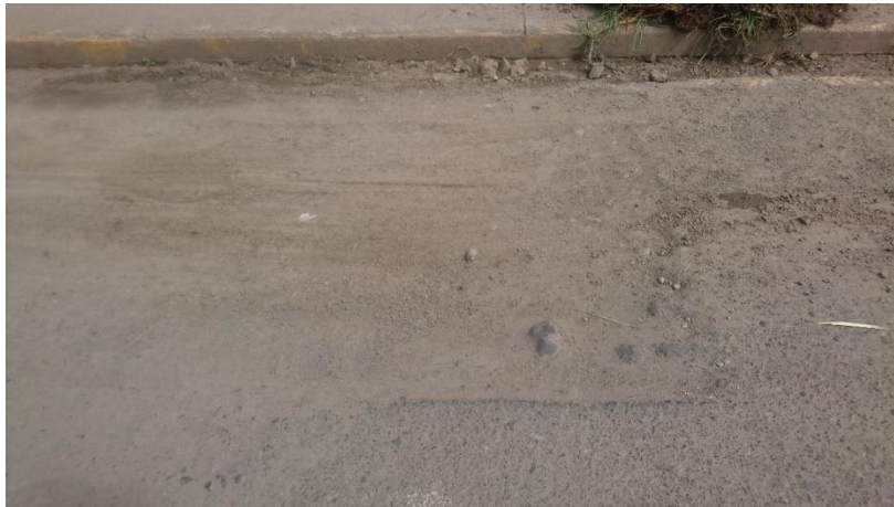
Ilustración 2-4: Abultamiento de media severidad. Fuente Autor.
