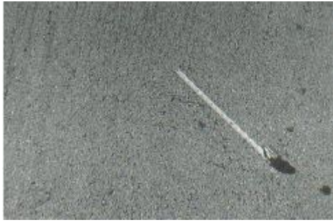
Ilustración 2-17: Grieta Parabólica de baja severidad, Fuente: Vásquez, 2002.
