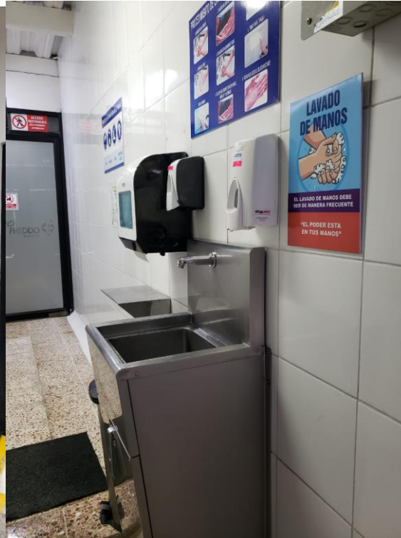
Ilustración 17 Área de desinfección
