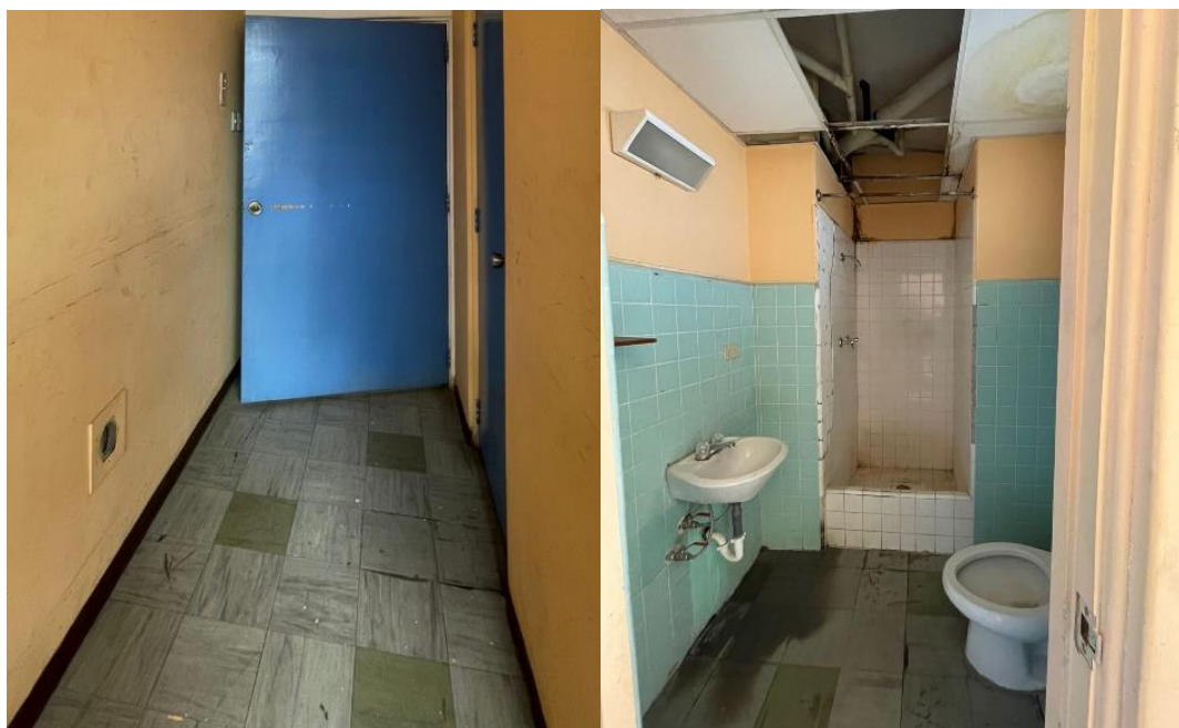
Figura 2.2 Estado del piso de vinil de habitaciones del quinto piso.
