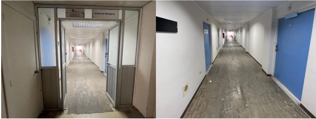
Figura 2.3: Estado de los pisos del pasillo del quinto piso del HVCN
