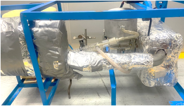
Fig. 5. Evaporador y silenciador recubierto de lana de vidrio.
