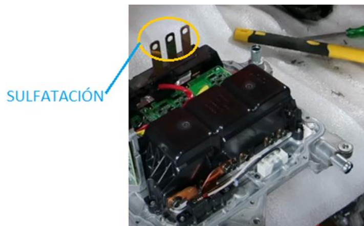
Figura 9. Inversor con bornes sulfatados [10]
