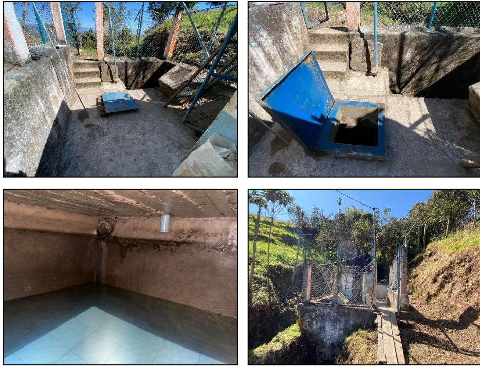
Figura 2.3. Tanque de Almacenamiento
