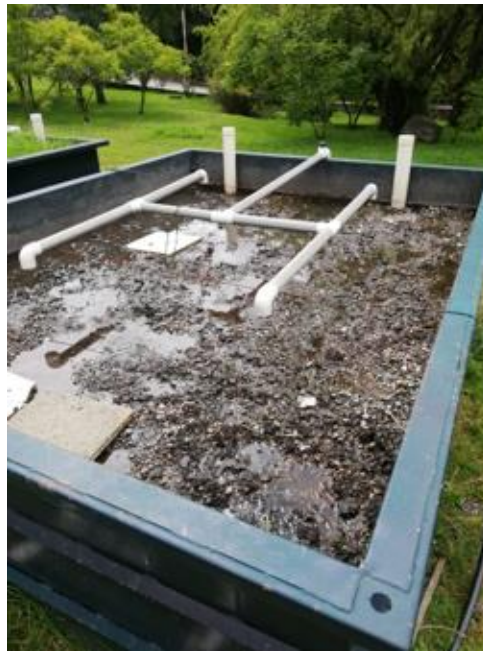
Figura 7: Humedal Piloto - Fase 3
