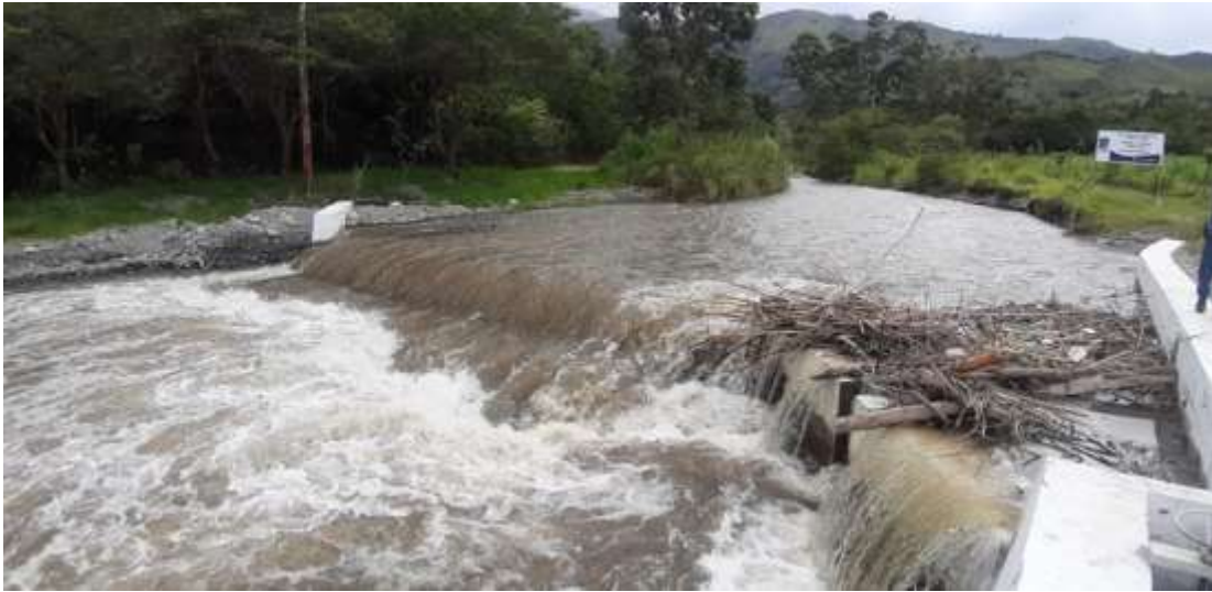
Estado de la bocatoma del canal de riego, 11 de febrero del 2023
