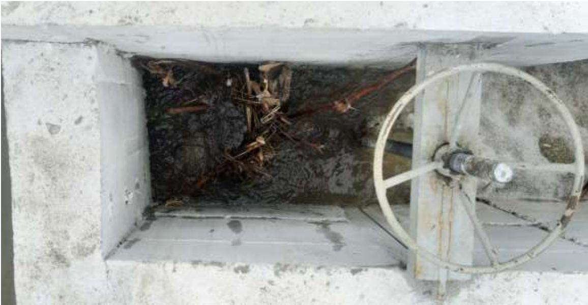
Escombros acumulados en la bocatoma del canal de riego
