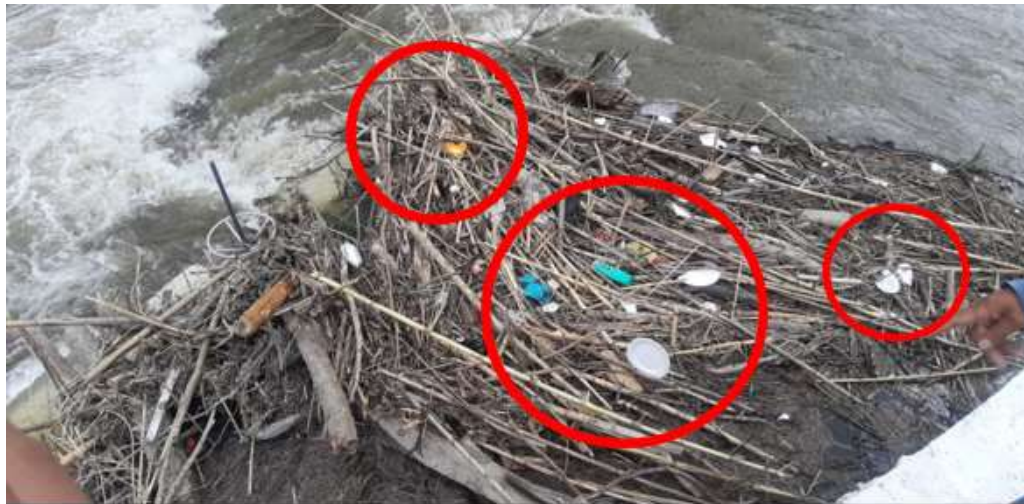
Productos y sustancias contaminantes entre los escombros acumulados en la bocatoma
