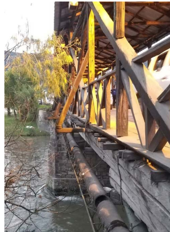
IMG 05. Puente vehicular en malas condiciones, imagen de autoría propia.
