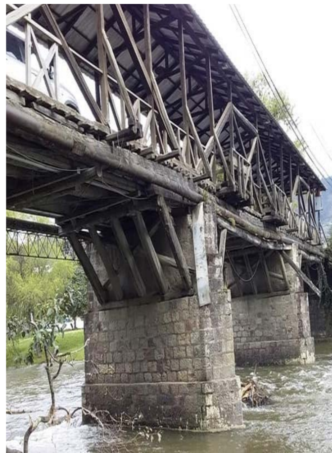
IMG 02. Puente vehicular en malas condiciones, imagen de autoría propia.
