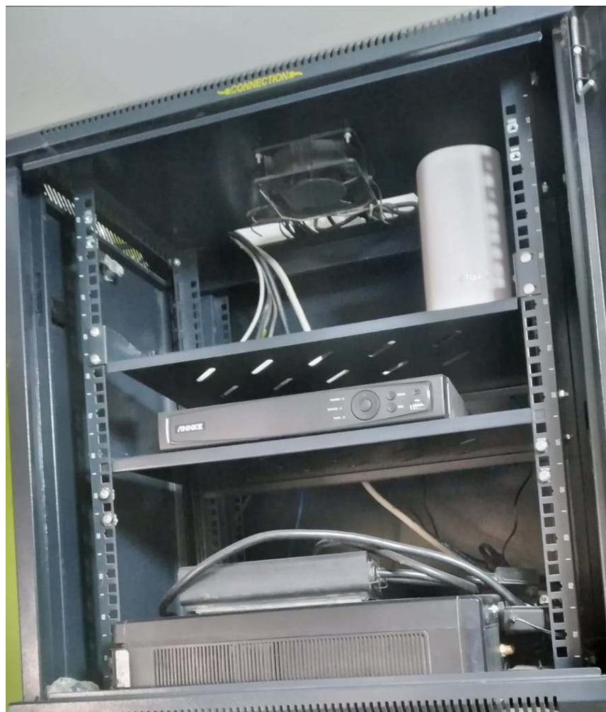
Figura 105. Infraestructura Red LAN 3.
