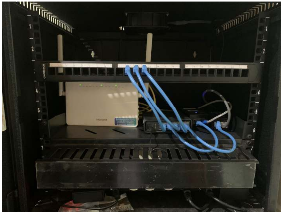
Figura 104. Infraestructura Red LAN 2.
