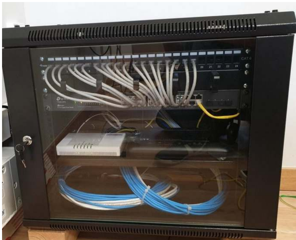
Figura 103. Infraestructura Red LAN 1 .
