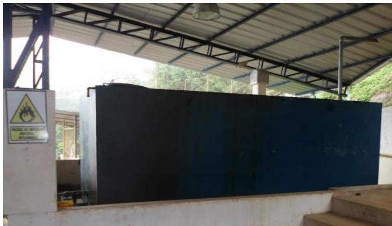
Cubeto de almacenamiento de combustible 1
