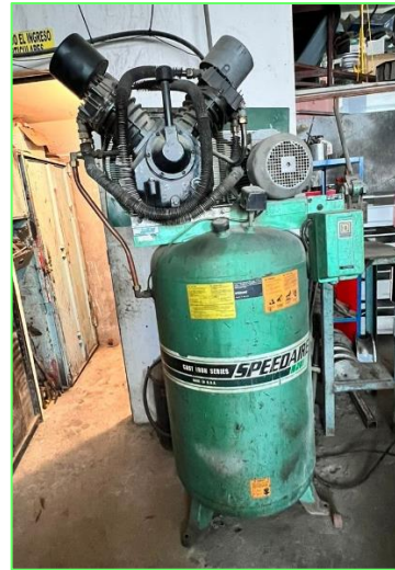
b) Compresor de 10 HP y motor de 10HP
