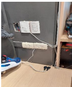
Figura 8 Riesgos por objetos mal instalados.
