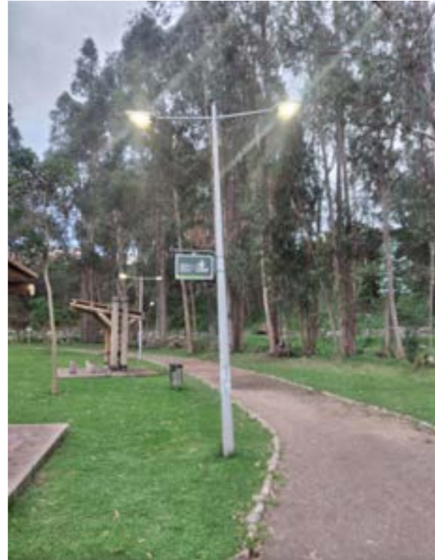
Fig. 42 Iluminación Parque Tarqui-Guzho Fuente: Propia
