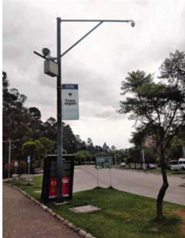
Fig. 41 Cámara de vigilancia, Parque Tarqui-Guzho Fuente: Propia
