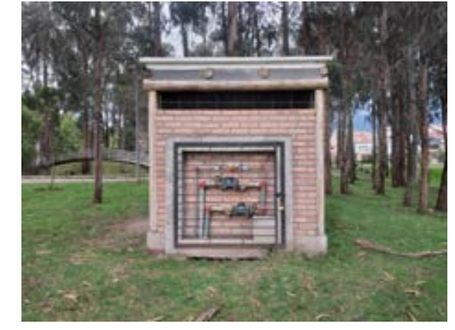
Fig. 36 Cuarto de máquinas, Tarquí-Guzho Fuente: Propia
