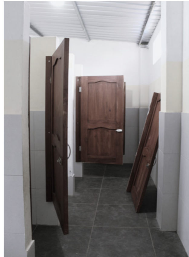
Fig.100. Puerta rota de bloque de baños 1. Fuente: Propia.
