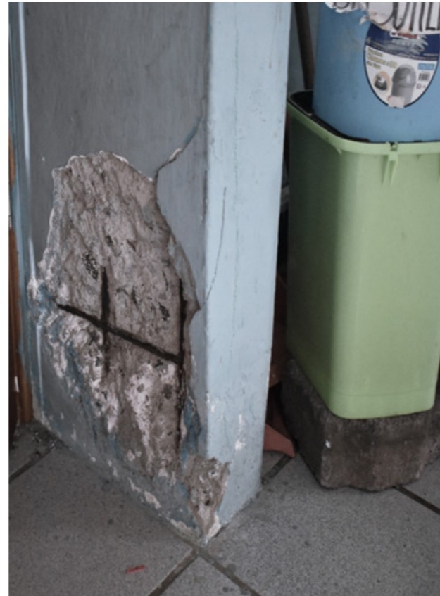
Fig.95. Deterioro estructural de la columna Fuente: Propia.
