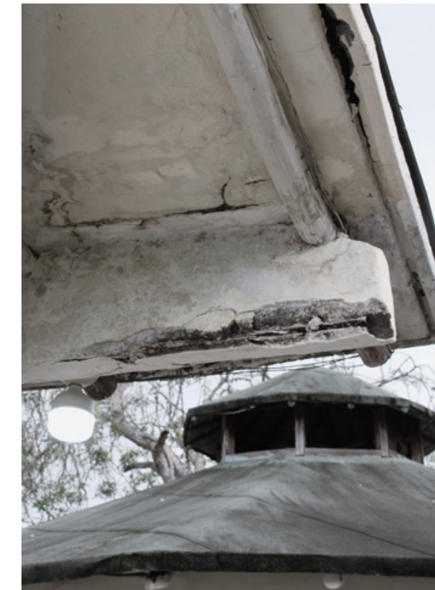
Fig.98. Deterioro estructural viga Fuente: Propia.
