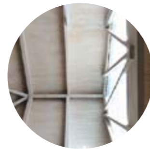
Cielo raso Se deja vista la estructura de madera de la cubierta
