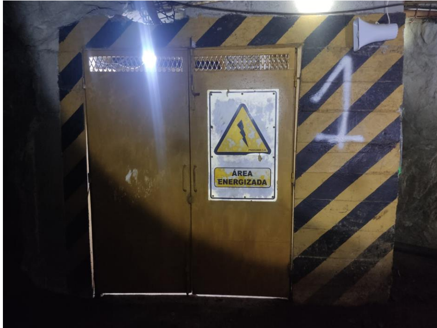
Ilustración 8. Sitio de transformador eléctrico.
