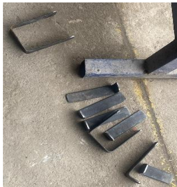
Figura 15. Proceso de fabricación de soportes
