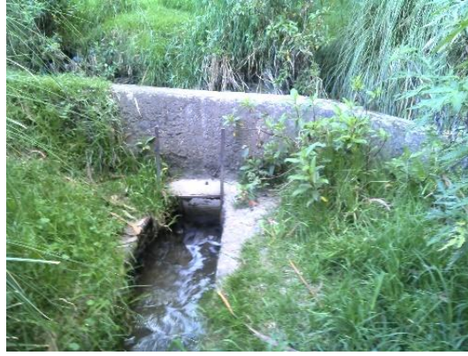
Figura 1.6. Ingreso del agua de la quebrada de Pucuhuayco al canal
