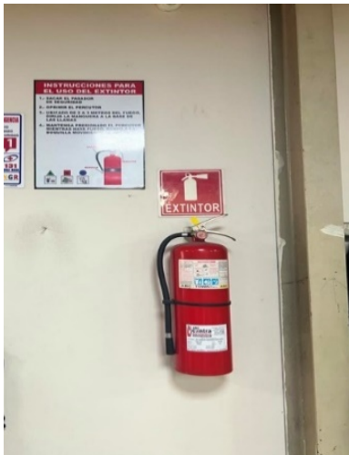
Extintor de Incendios
