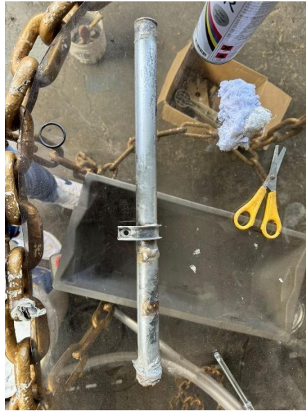
Figura 26. Tubo de agua dañado
