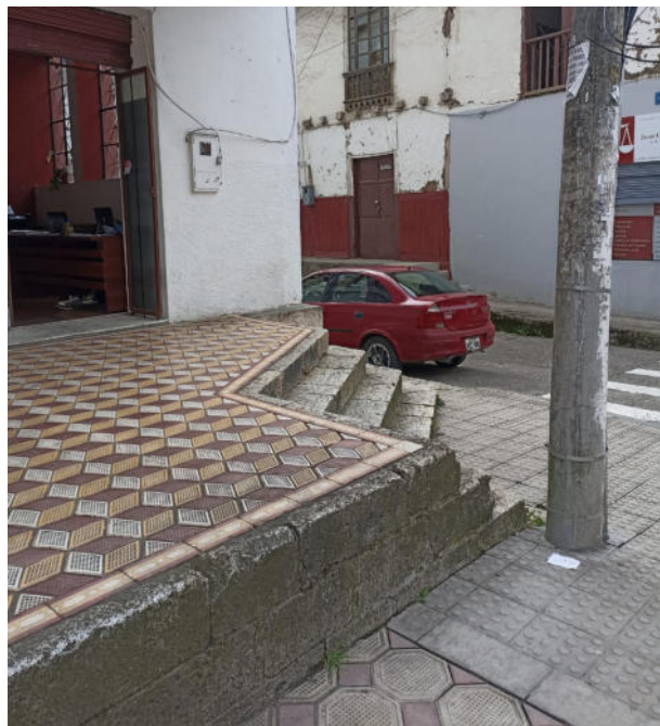
Fig. 156. Espacios sin elementos para la movilidad reducida. Imagen: propia
