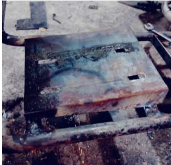
Figura 1.31. Base del motor instalada.
