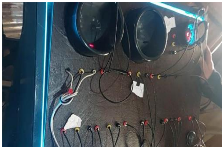
Figura 29 Cables acomodados en sus respectivos terminales
