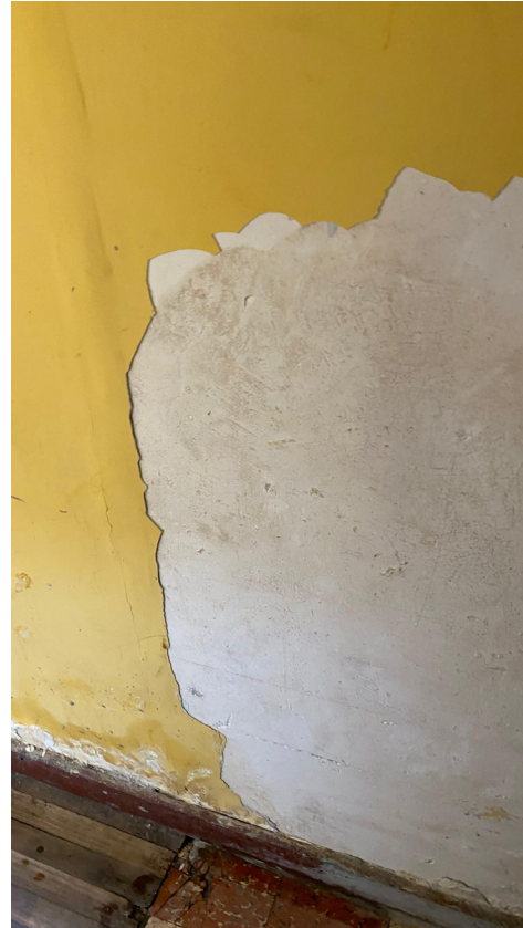
Desprendimiento de enlucidos.
