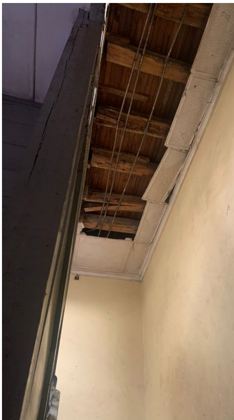
Desprendimiento de elementos estructurales.
