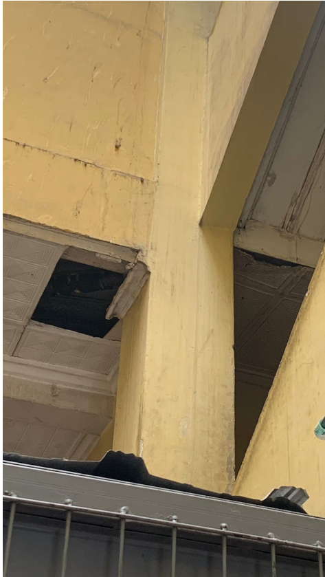
Desprendimiento de cielo raso.
