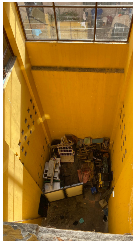
Falta de áreas de almacenamiento.
