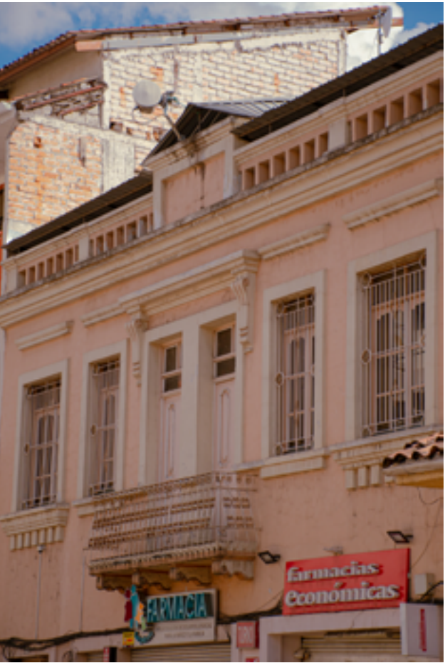
Figura 38: Estado actual de la fachada frontal Fuente: Autoría propia (2024)
