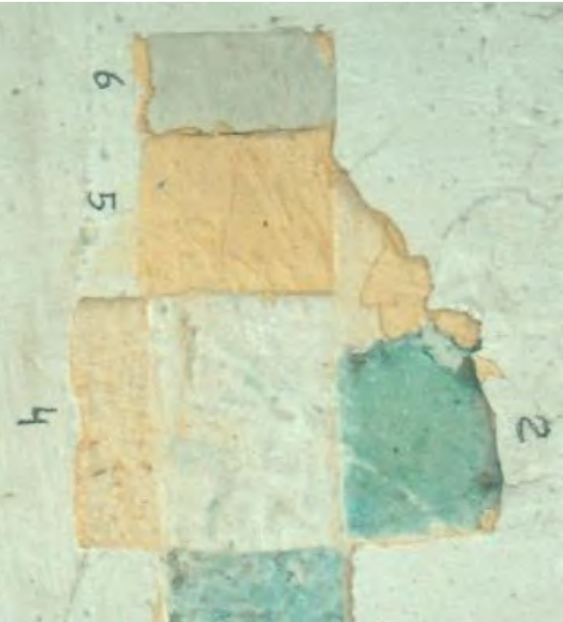
Fig 04.Cala de prospección en pared en la edificación ubicada en la calle Honorato Vásquez 7-36 entre Borrero y Luis Cordero. Fuente: María Cecilia Achig (2001)
