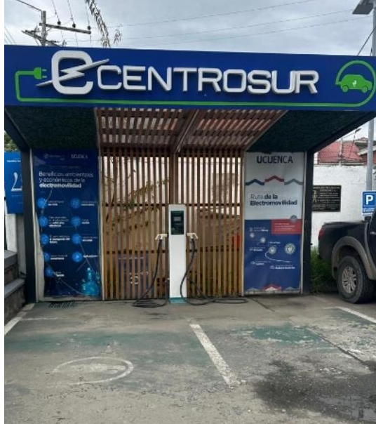
Figura 19: Estación Centro sur Empresa eléctrica
