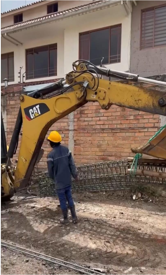
Figura 4a. RiesgoSignificativo3: Golpes por maquinaria en movimiento. Complejo Médico Roma. 11/01/2025.
