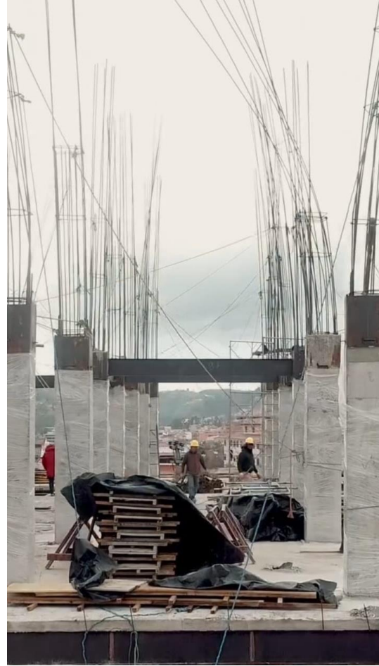
Figura 3b. RiesgoCrítico4: Caída a distinto nivel. Complejo Médico Roma. 16/11/2024.
