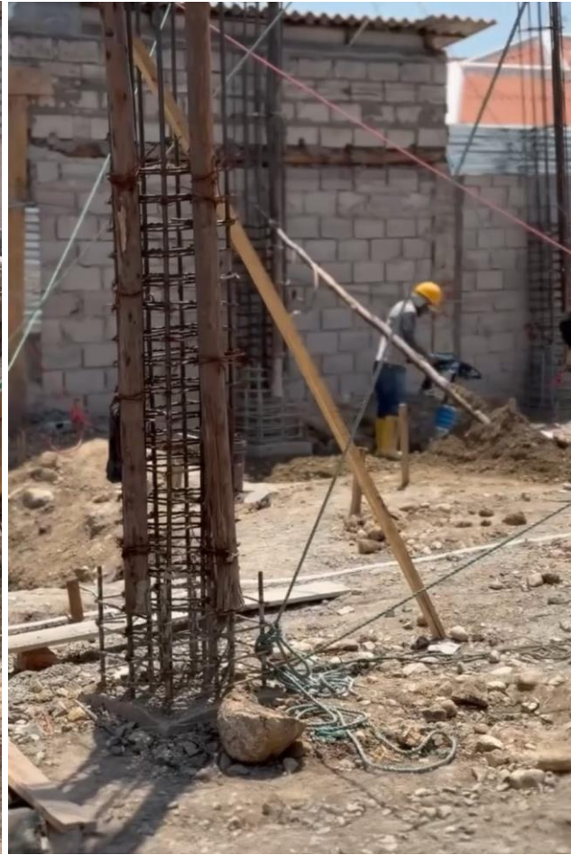
Figura 4b. RiesgoSignificativo4: Colapso de estructuras temporales. Complejo Médico Roma. 08/02/2025.
