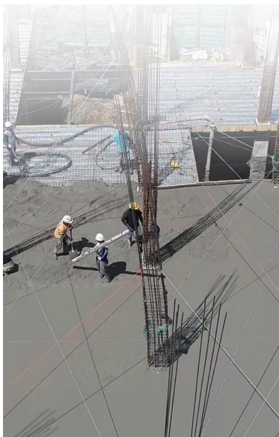
Figura 2a. RiesgoSignificativo1: levantamientos manuales de carga Complejo Médico Roma. 11/01/2025.
